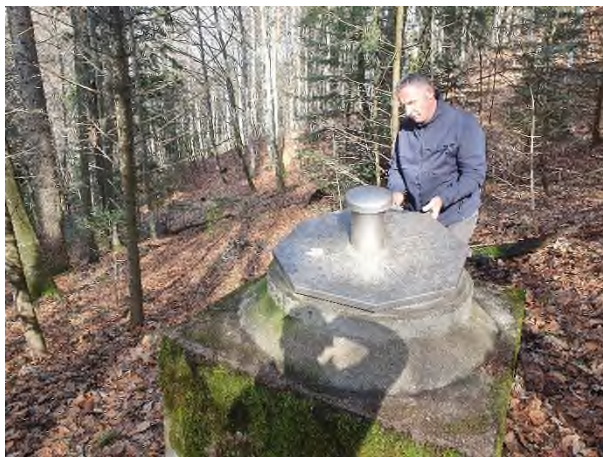
Figure 3: Sources de Prévondavaux, chambre de captage inférieure.
