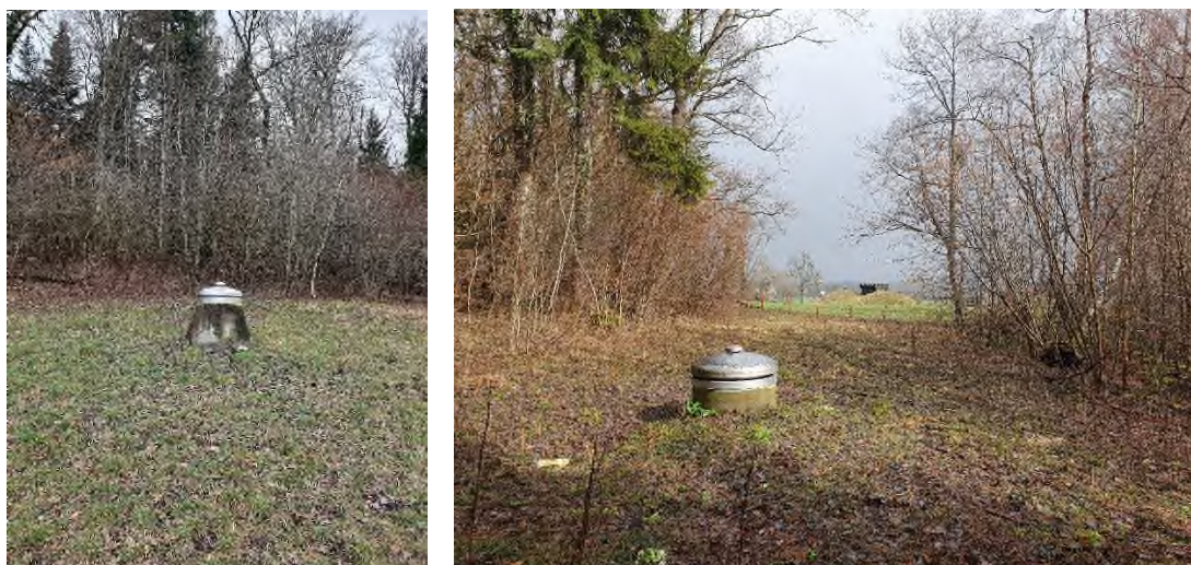
Figures 22 et 23: Situation des chambres de captage de l'eau des Sources du Bois de la Rosière.
